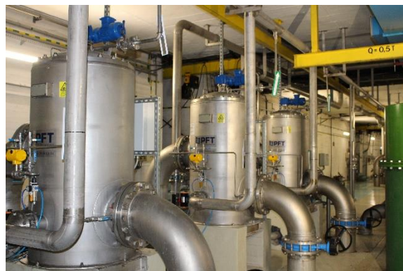
Zdj.1 Filtry samoczyszczące FSDN300 wody chłodzącej w EW Żarnowiec
