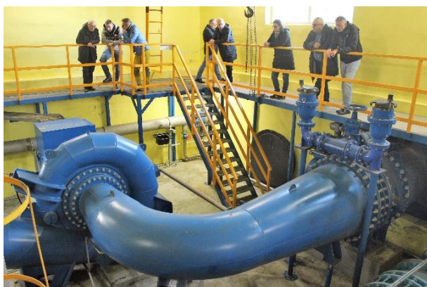
Fot.10 Odzysk energii w komorze redukcyjnej KP-3 Wodociągów Miasta Krakowa
