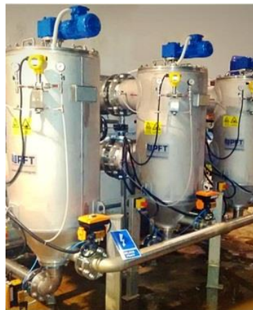
Zdj.2 Filtry samoczyszczące wody w EW Włocławek
