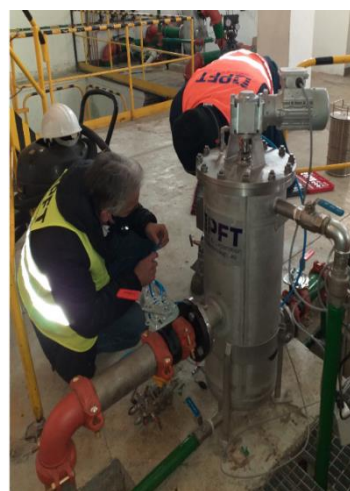
Zdj.3 Filtr samoczyszczący wody w EW Niedzica, poziom filtracji 0,025 mm
