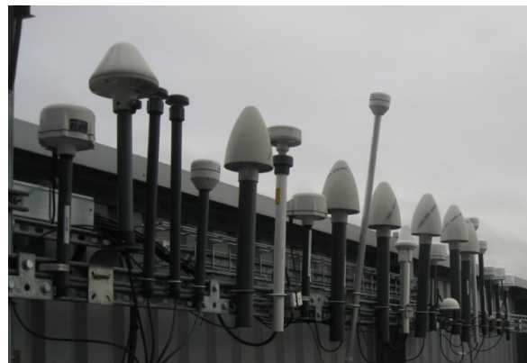
Rys. 6 Przykład wadliwej instalacji anten
