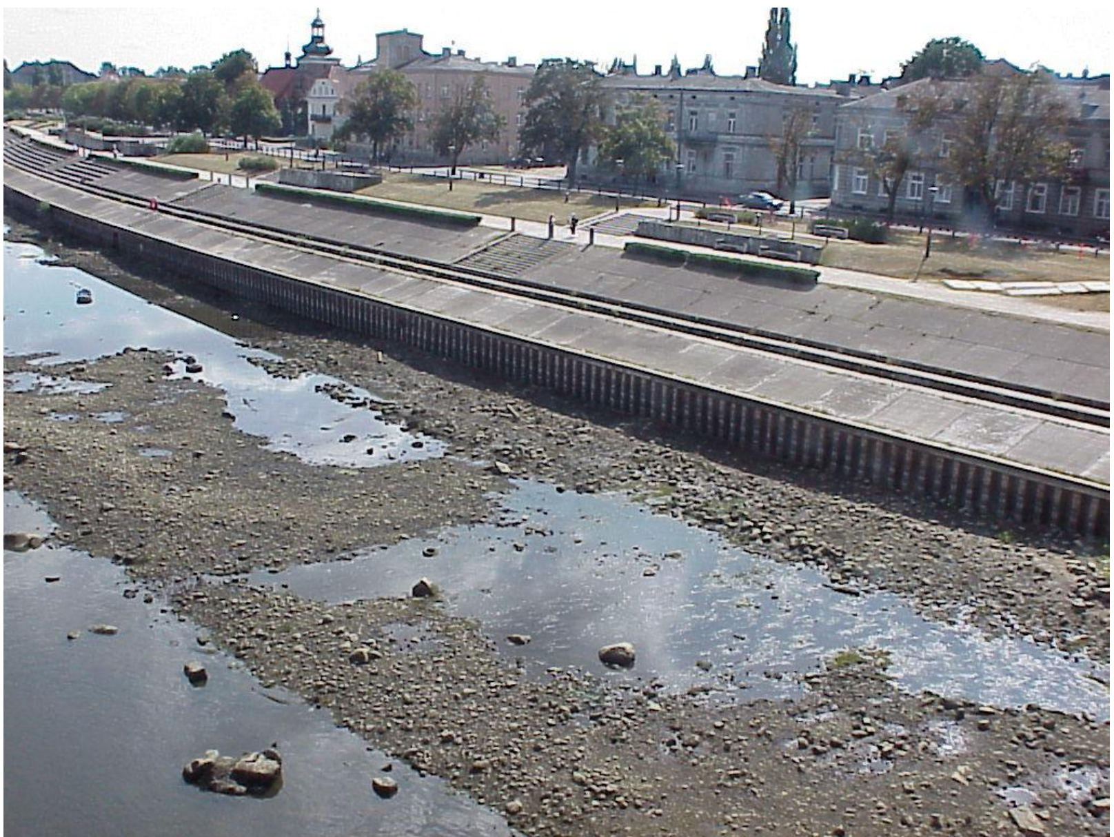
Włocławek – skutki obniżenia lustra wody w Wiśle (niski stan wody)
