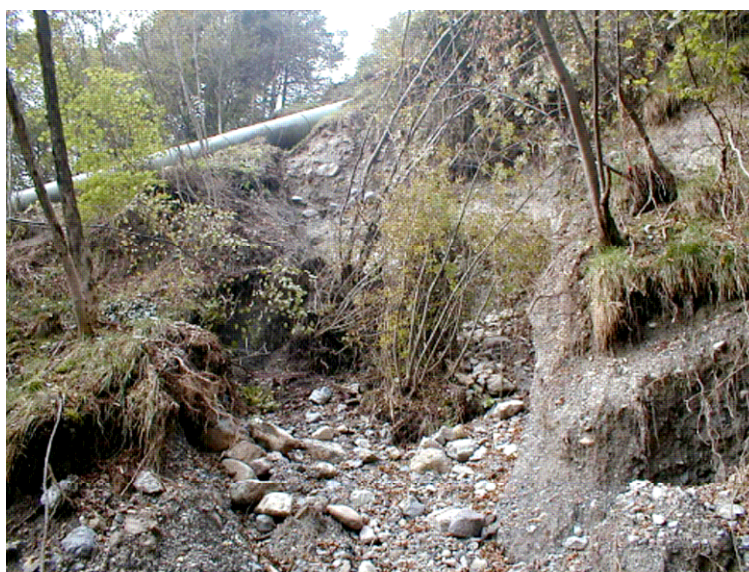
Typowy problem: Osuwanie się gruntu pod rurociągiem derywacyjnym (Nino Frosio)
