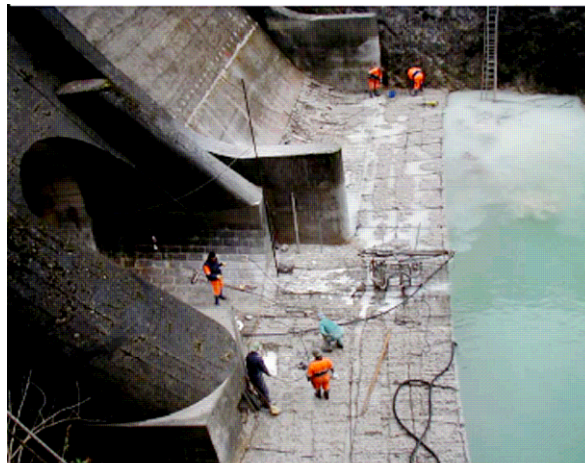
Środki zaradcze: iniekcje zaprawy betonowej, poprawa drenażu (Nino Frosio)
