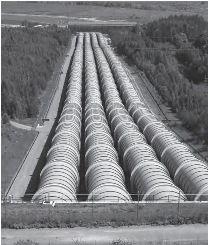
Elektrownia Szczytowo-Pompowa Żarnowiec w Czymanowie – rury, które łączą zbiorniki górny i dolny (fot. Joanna Karnat)
